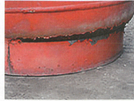
底の塗装がはがれた消火器
